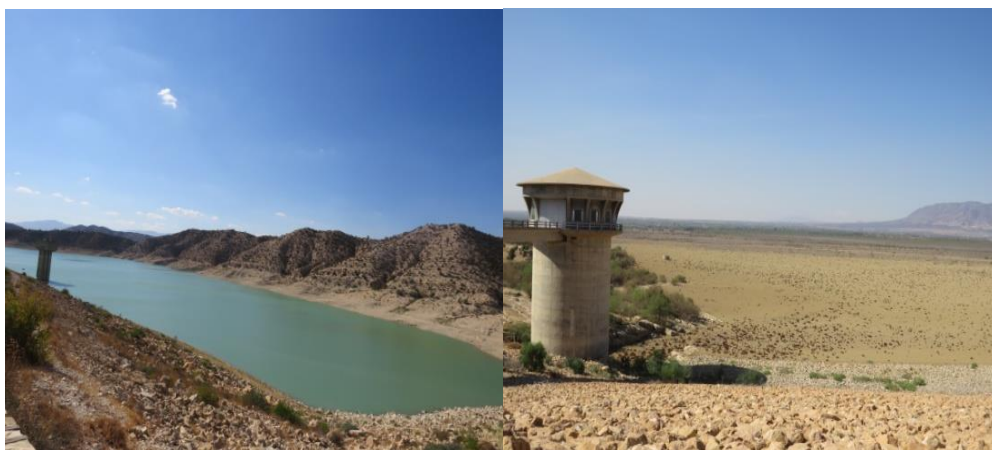
Etat du barrage de Houareb (octobre 2021)
