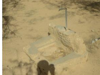
Etat des robinets d'eau à Segdoud.
