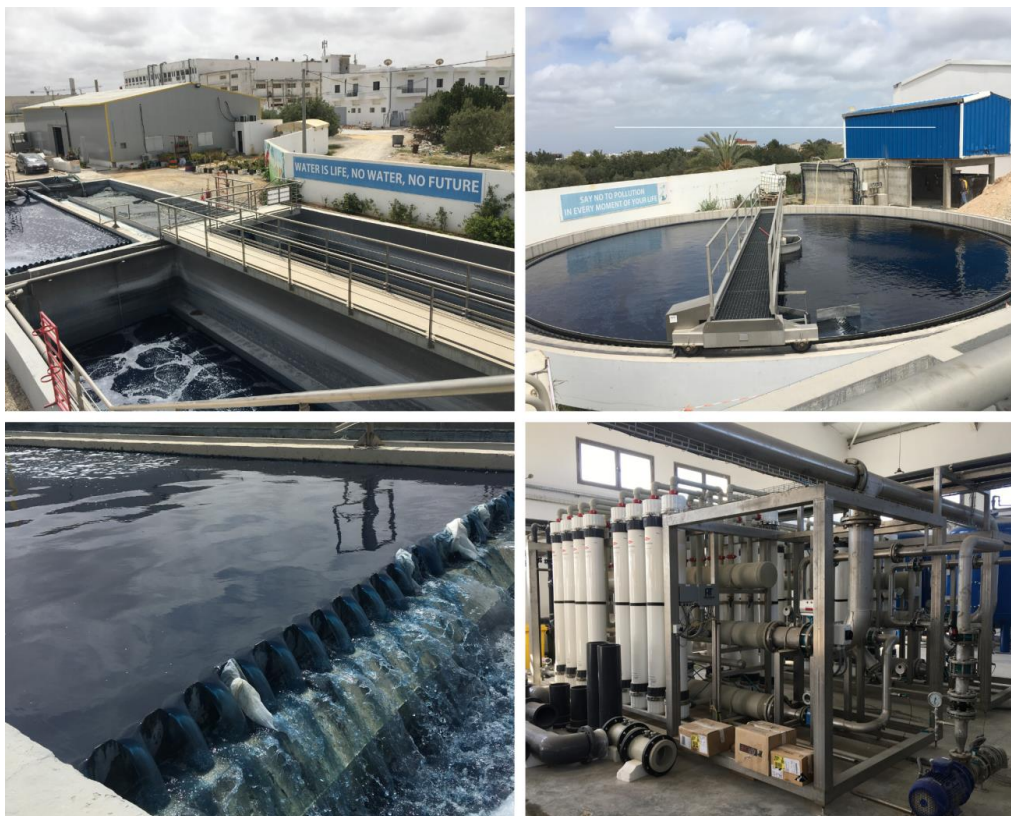
Photo 12: La station de traitement biologique de SARTEX Source : Prise par S. Chakroun, le 03/03/2022 à la station de traitement SARTEX
