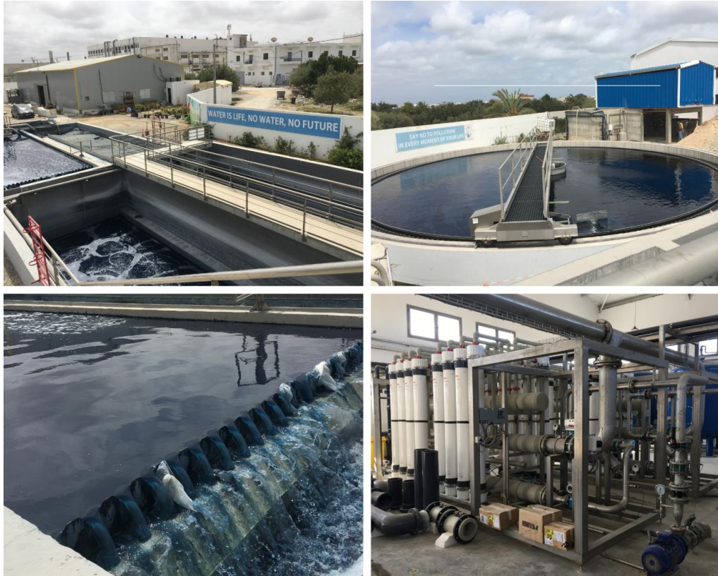
Figure 5: La station de traitement biologique de SARTEX
